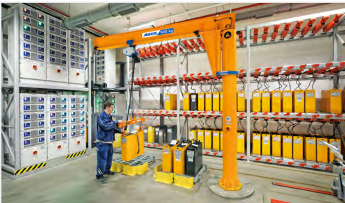
Roterbar 360° ABUS pelarsvängkranar, upp till 6,3 t (upp till 4 t. med kättingtelfer)
